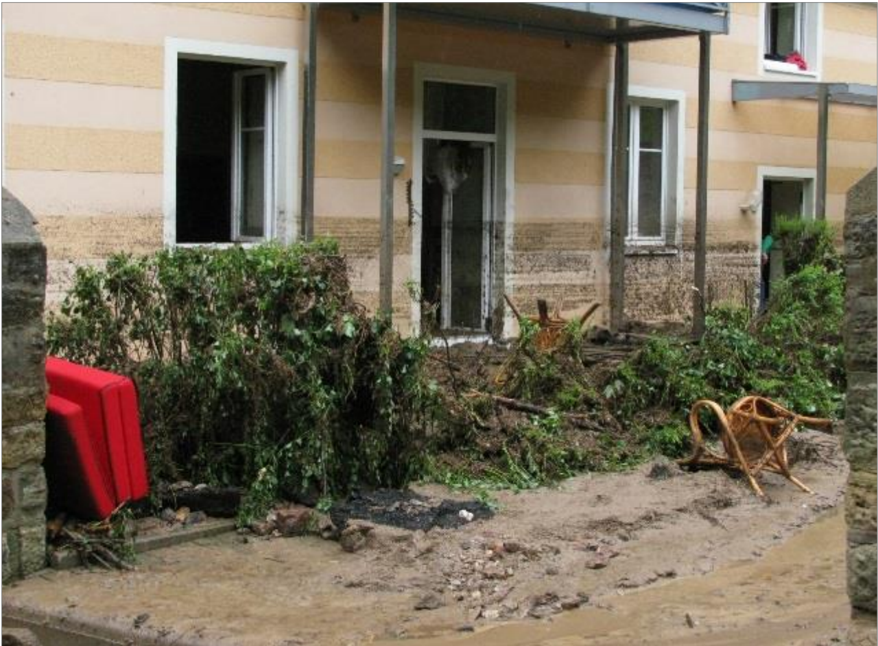
Abb. 1 Geschwemmsellinie in ca. 1,50 m Höhe an der hangzugewandten Seite eines Gebäudes im Gebiet Meißen (An der Hohen Eifer 2, Meißen, N51.145405, E13.458421), Quelle: Golz/IÖR 2014.
